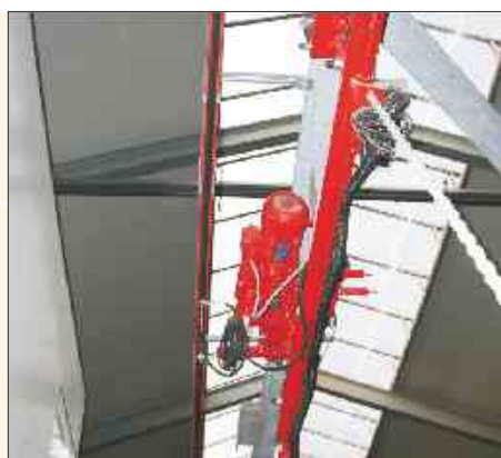
Stromversorgungs- und Laufschiene.
